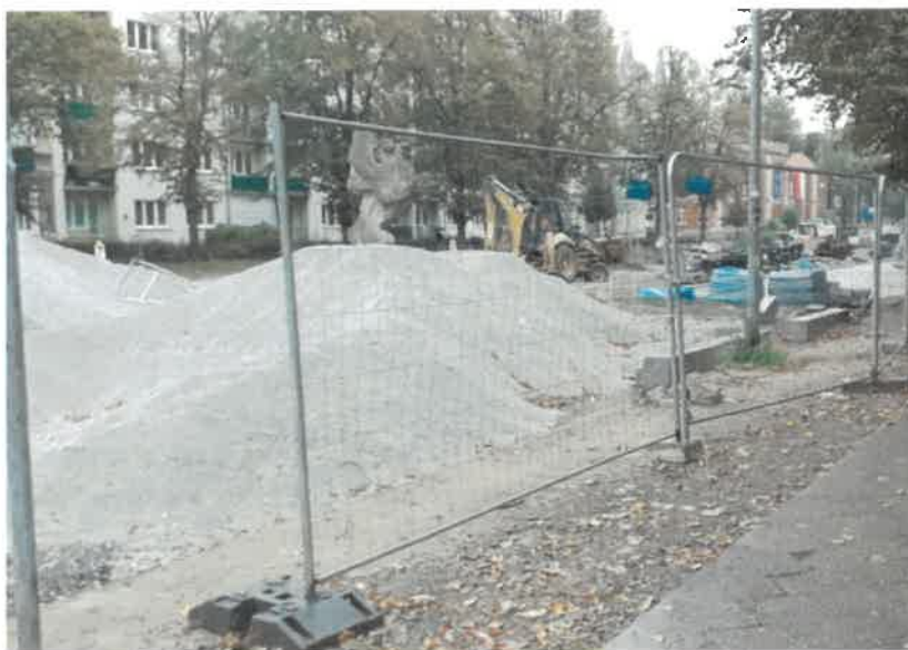
Fot.1. Przykład ogrodzenia ochronnego
