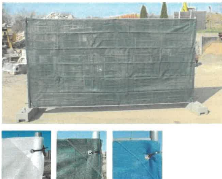
Fot. 2. Przykład ogrodzenia ochronnego w przypadku ochrony przed zapyleniem
